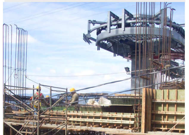
Imagen de la estructura electromecánica de una de las estaciones.
