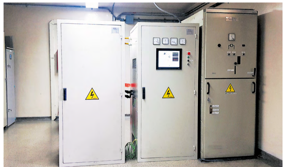
A la izquierda, el gabinete de potencia y en el centro, el gabinete de control o "cerebro" de los ultracapacitores.
