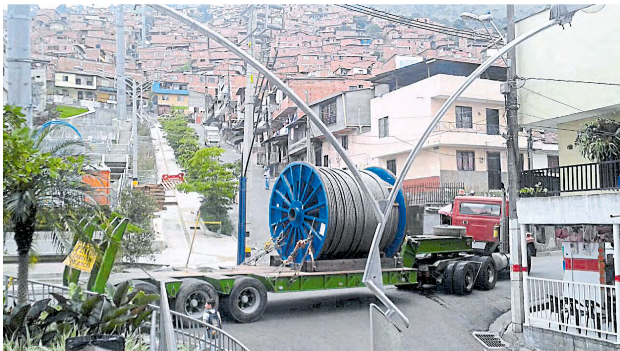
Hace pocos días llegó la bobina del cable portador tractor a la estación El Pinal, una de las tres que compone el Metrocable
